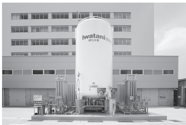
液化水素貯槽
