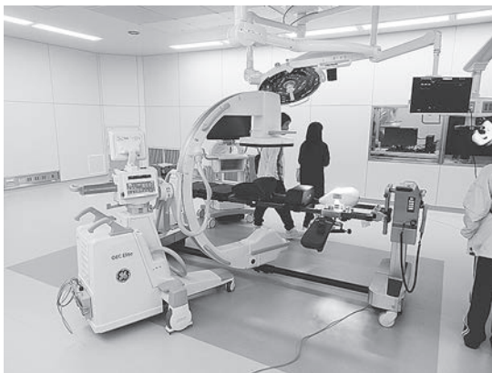
バイオクリーンルーム
